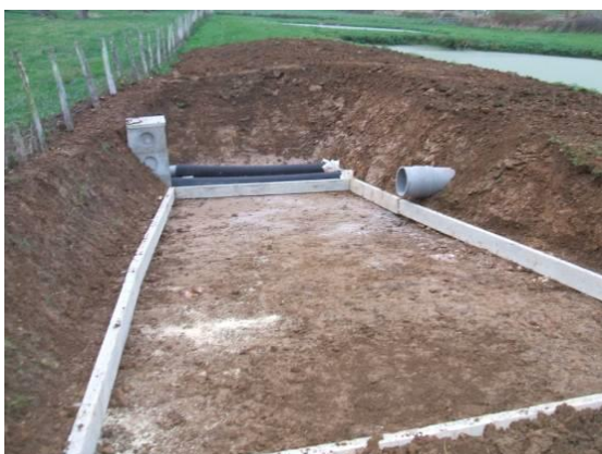
Zone de récupération des lentilles
