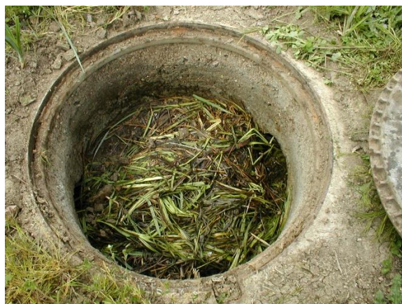
Nid de ragondins dans un regard d'assainissement
