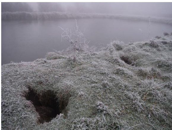
Exemple de dégâts occasionnés sur les berges d'une lagune
