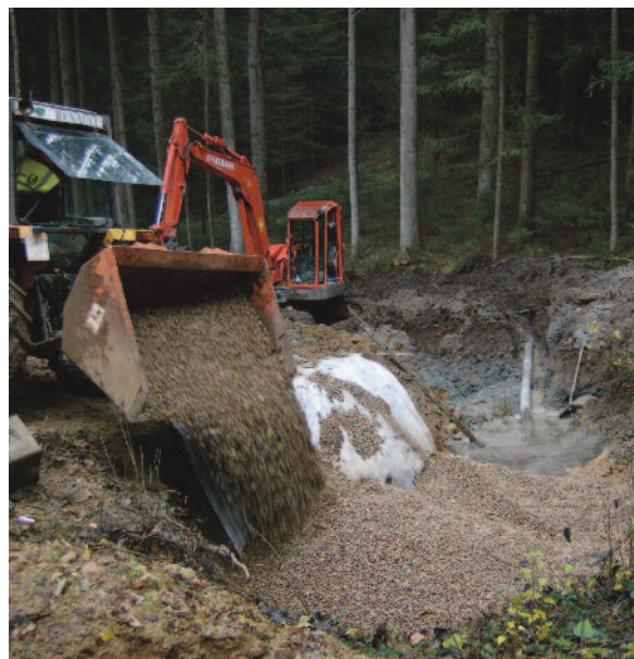
Captage d'une source sur la commune de Matour
