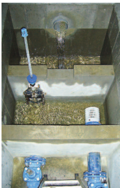
Bac de décantation et départ de l'eau captée
