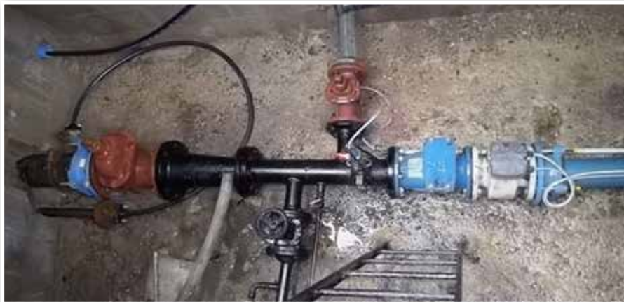
Organe de comptage sur un réseau
