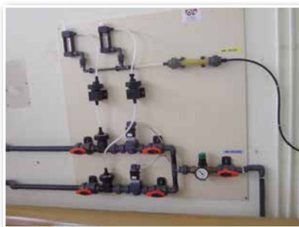
Unité de chloration
