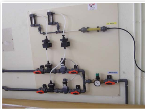
Unité de chloration
