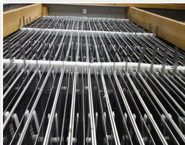
— Détail d'une unité d'électro-décarbonation —
